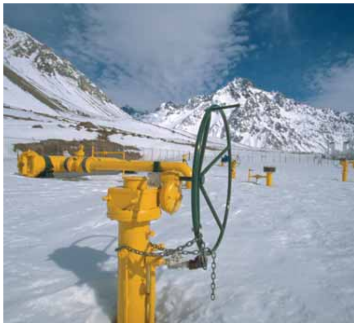
Chili : gazoduc de 460 kilomètres reliant le réseau Argentin à Santiago du Chili à travers la cordillère des Andes
