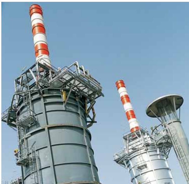
Nigéria : usine de liquéfaction de gaz de Bonny
